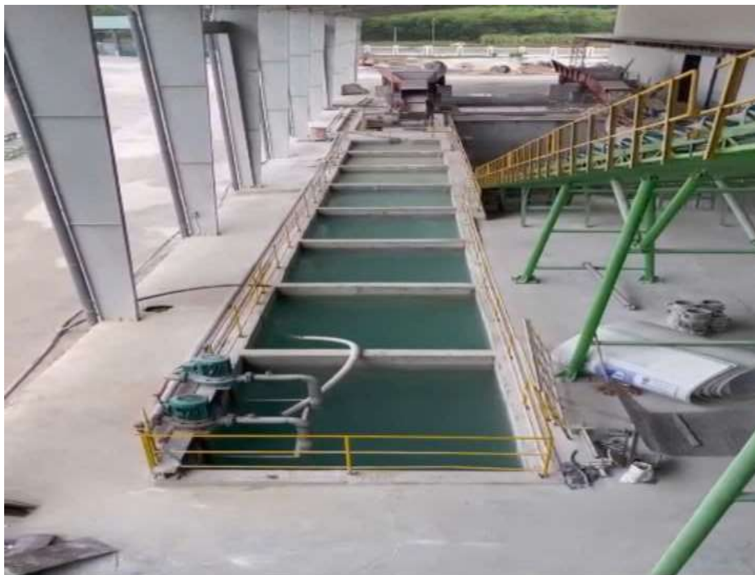
Hình 7. Hệ thống bể lắng 8 ngăn
