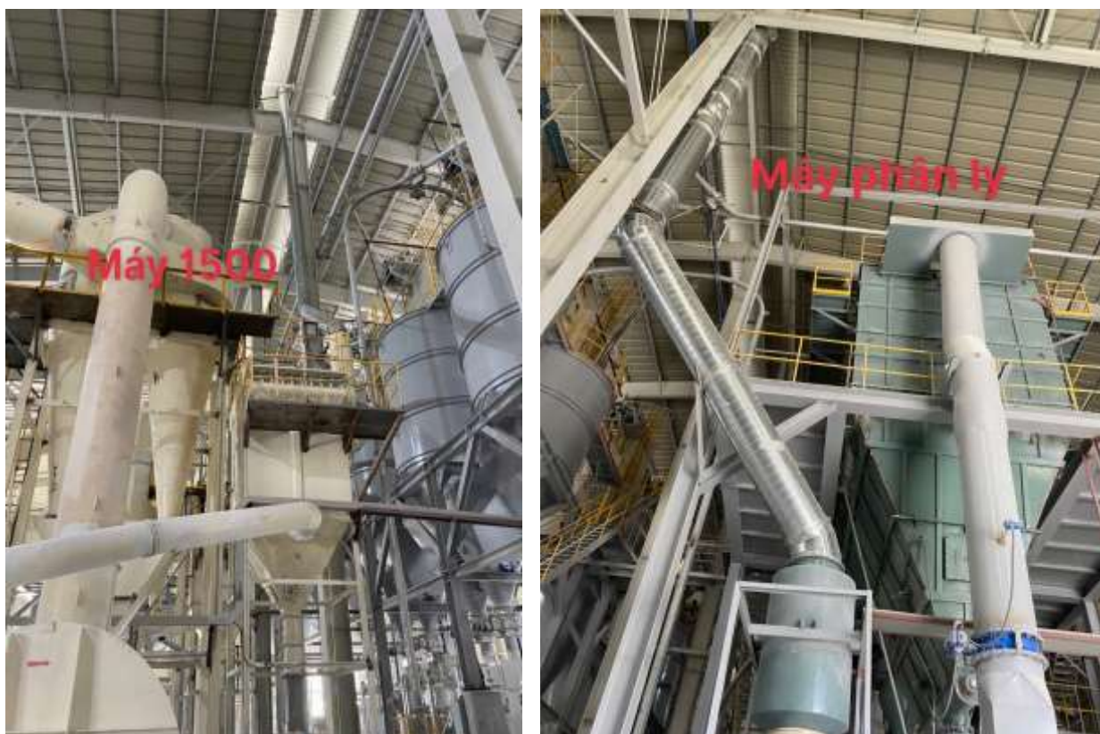
Hình 11. Hình ảnh ống thoát khí một số máy tại Nhà máy
