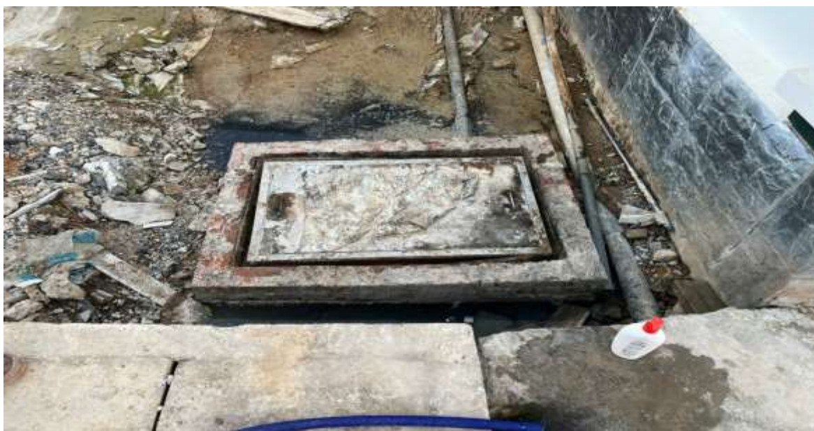
Hình 4. Bể tách dầu của Nhà máy
